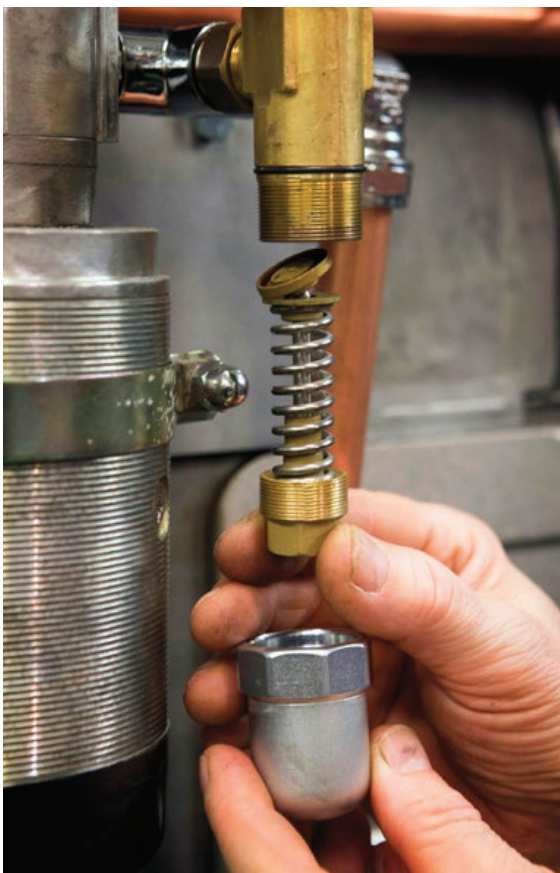
En säkerhetsventil från en varmvattenberedare har byggts om för att fungera som övertrycksventil till förtryckspumpen. Hela motorbygget präglas av fiffiga och genomtänkta lösningar.
